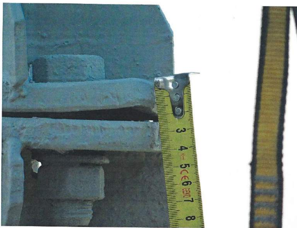
Komin K1 – rozwarstwienie styku
