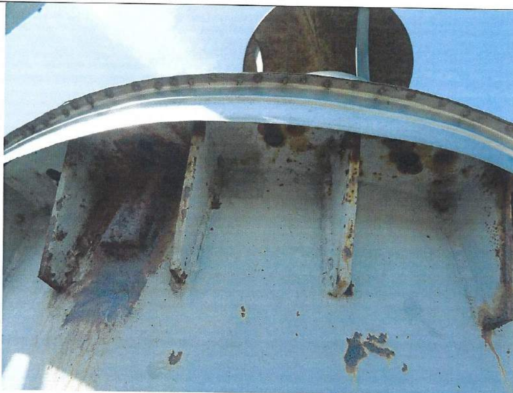
Komin K1 – miejscowa korozja
