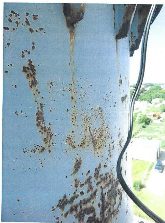
Komin K1 – miejscowa korozja
