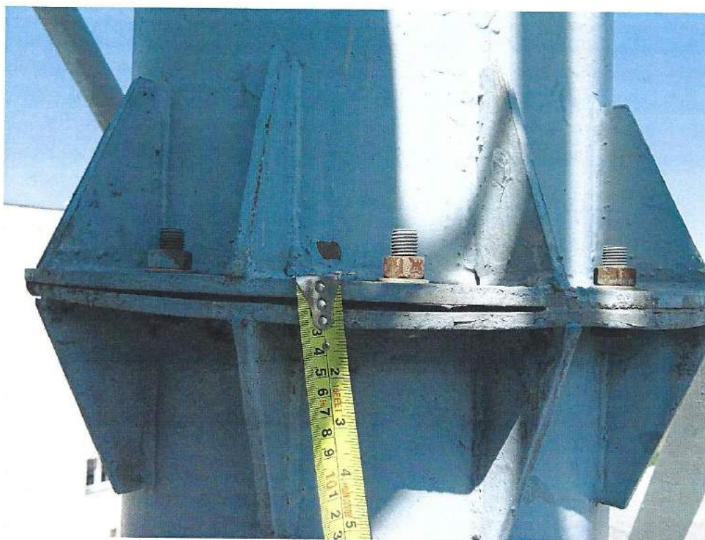
Komin K2 – rozwarstwienie styku
